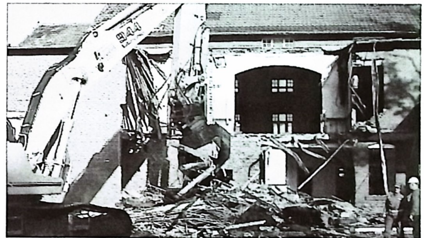
IN SCHUTT UND TRÜMMER legte der Abrissbagger den ehemaligen Gasthof Brill an der Hauptstraße. (Foto: Wieneke)
